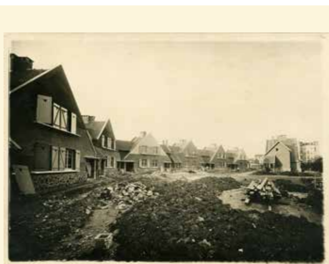
→ Cité-jardin : vue de chantier, 1925-1927, 16 avenue de la Boissière, 93 230 Romainville, Commanditaire : SALEFN --- anonyme, n.d. Académie d'architecture/ Cité de l'architecture et du patrimoine/Archives d'architecture du XX e siècle
